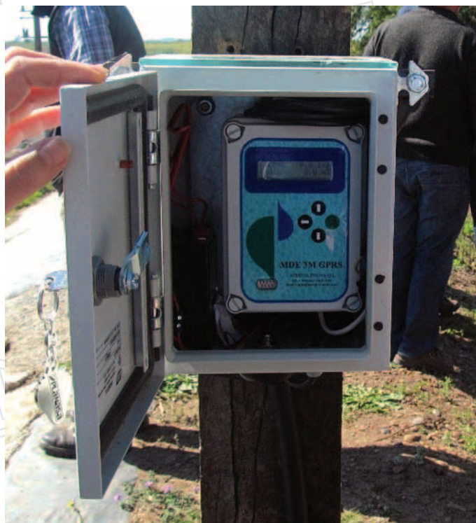
Instrumento de medición de caudales y telemetría
